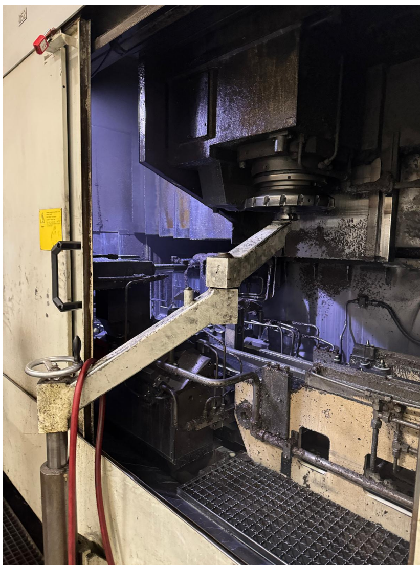
IMAGE 30. Intérieur d'une machine-outil de l'atelier (vérins, flexibles hydrauliques et pneumatiques, chaînes porte-câbles), avec le bras de levage utilisé pour monter et démonter la fraise : ce type d'accès nécessite au préalable la pose d'un cadenas de consignation.
