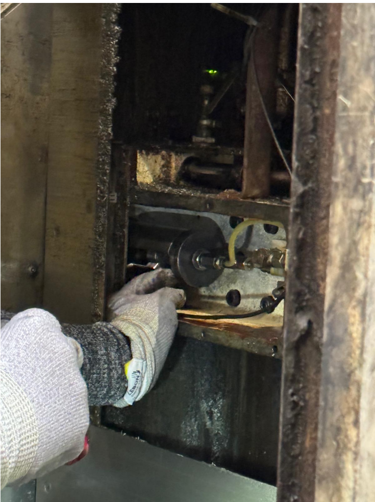
IMAGE 13. Intervention sur le capteur mentionné ci-dessus, à l'intérieur de la machine.
